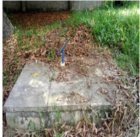
Figura 37. Registro na entrada do R.A.
