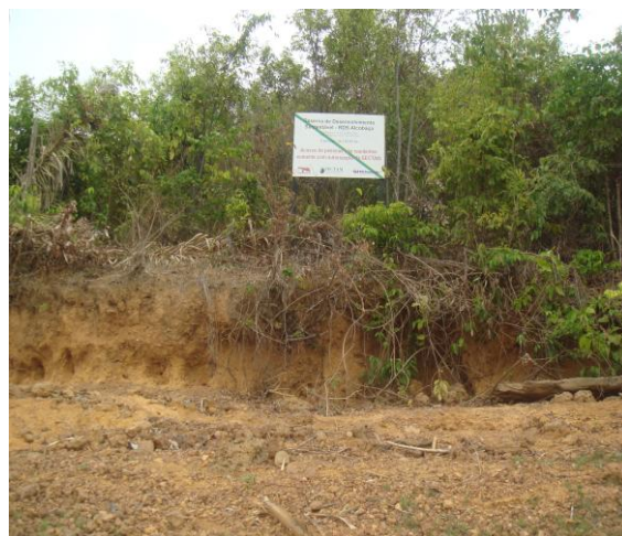
Figura 20 - Erosão de margem. Fonte. Acervo do autor, 2010.
