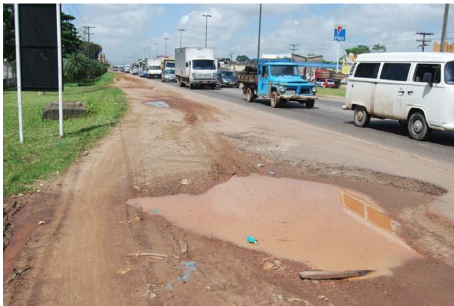
Figura 4.27 Precariedade do Acostamento, BR 316, Km 8, Sentido Crescente, Março/2013.
