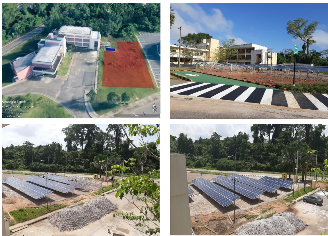
Figura 3.14 - Área do CEAMAZON, com instalação de sistema fotovoltaico
