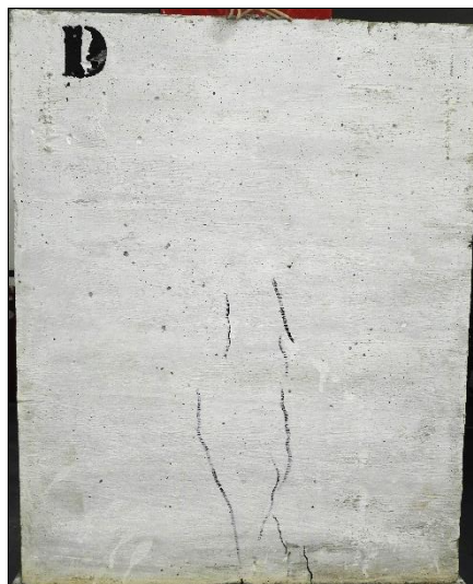
Figura 4.54 - Fissuração do modelo D
