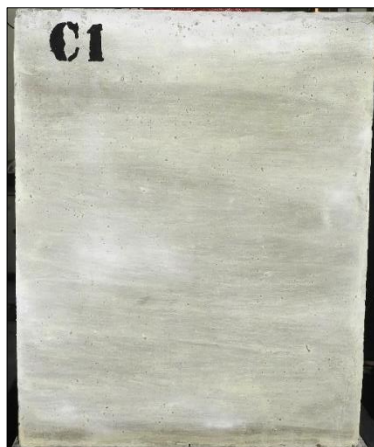
Figura 4.52 - Fissuração do modelo C1
