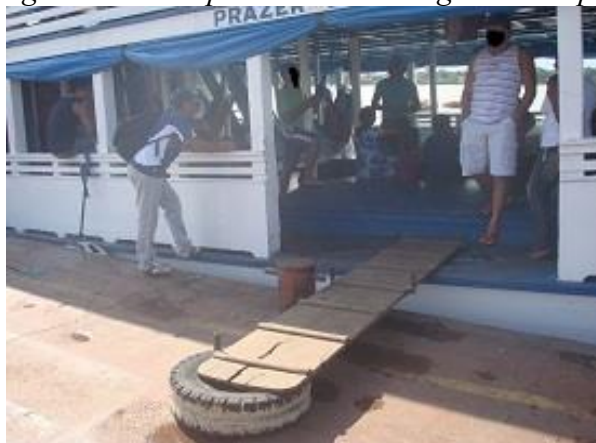
Figura 56 - Rampa de acesso sem guarda corpo.
