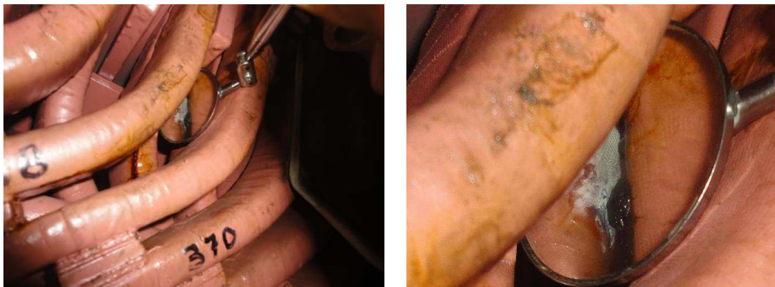
Figura 7.5 – Barras da ranhura 214 apresentam vazamento de resina da impreguação possivelmente por deficiência no processo de cura e a barra de fundo apresenta sinal de deterioração da superfície possivelmente por efeito corona ou descargas parciais.
