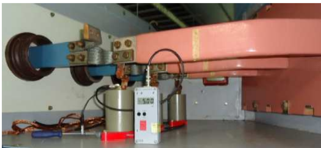
Figura 3.1 – Sinal aplicado de calibração [Arquivo Técnico Eletronorte, 2009].
