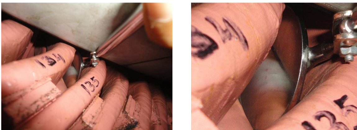
Figura 7.4 – Barra de fundo da ranhura 134 apresenta sinal de aquecimento da pintura de acabamento da superfície provocado possivelmente por efeito corona
