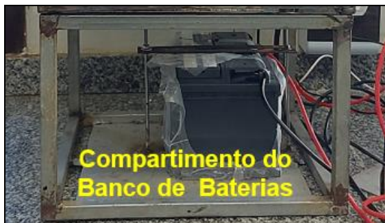
Figura 68 - Compartimento do banco de baterias do sistema fotovoltaico
