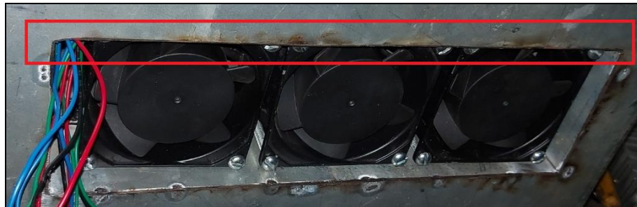
Figura 44 - Abertura de entrada de ar estreitada através dos ventiladores
