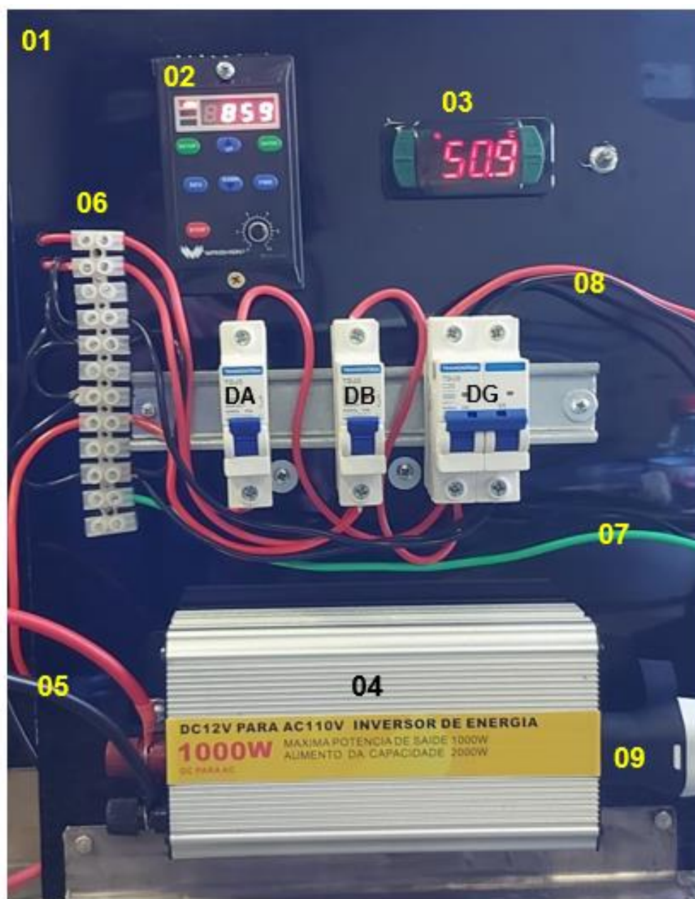
Figura 74 - Painel 1 Componentes de proteção, comando, monitoramento e controle
