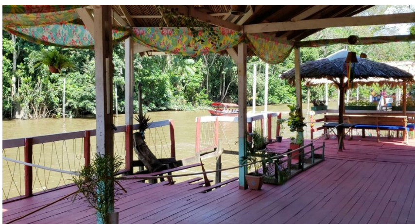
Figura 5 – Piso quebrado em restaurante na ilha do Combu.
