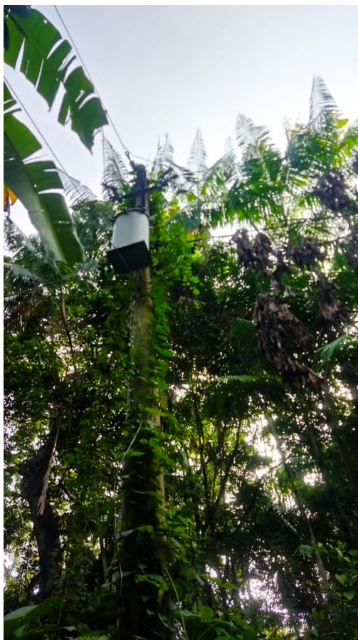
Figura 3 - Imagem de Torre de Energia coberta de vegetação por ausência de manutenção.
