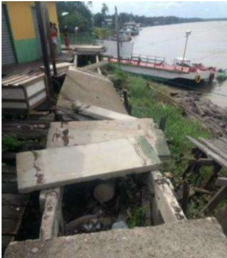
Figura 5- Terras caídas no arquipélago do Bailique, Amapá.
