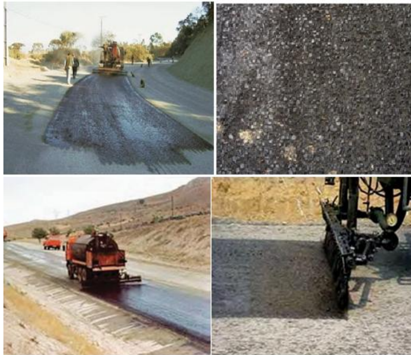
Figura 9: Processo de imprimação: Espalhamento do material ligante e o aspecto do solo [5].
