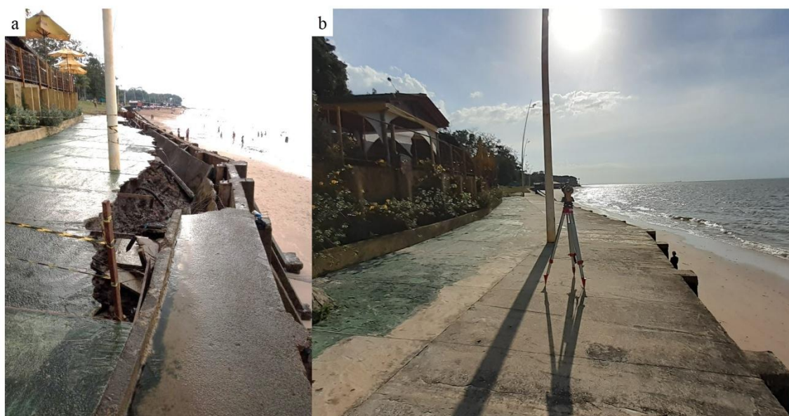
Figura 54. Imagem da praia do Paraíso (porção central): a) Erosão no muro de arrimo e geração de dano. Foto registrada em: 28/02/2021, e b) Muro reconstruído. Foto registrada em: 08/10/2021. Fonte: Autor.
