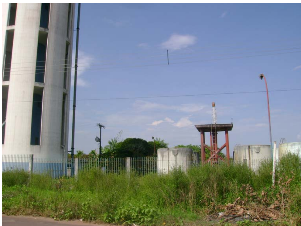
Figura 70 – Sistema de aeração no bairro Jaderlândia (julho/2007).
