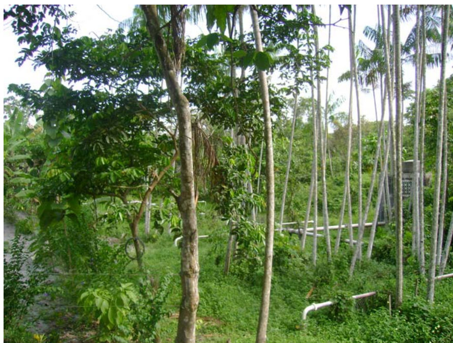
Figura 76 – Sistema de captação de água da COSANPA para abastecimento público (julho/2007).
